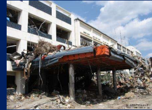
▶ 津波被害を受けた陸前高田市役所庁舎
